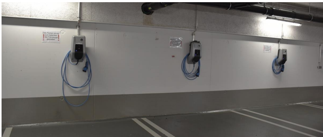
3 der 13 vorhandenen Ladestationen in der Tiefgarage des Gästehauses 4
