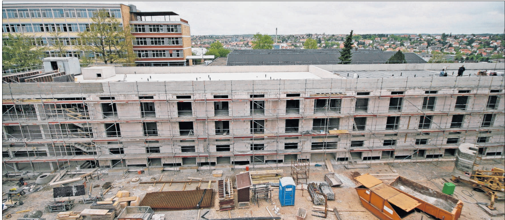
Über den Dächern der Ansbacher Kernstadt entstehen derzeit neue Lehrsaal- und Unterkunftsgebäude für die Landesfinanzschule. Richtfest wird am 14. Mai sein. Investiert werden in das Projekt rund 10,6 Millionen Euro (einschließlich einer Mensaerweiterung). Fotos: Reinhardt
